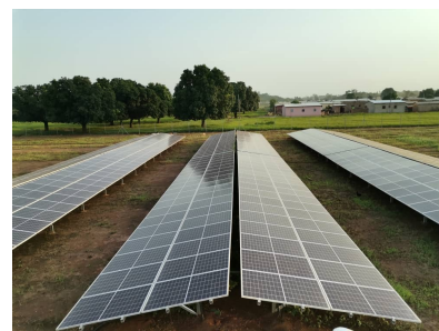
Mali: Ländliche Elektrifizierung
